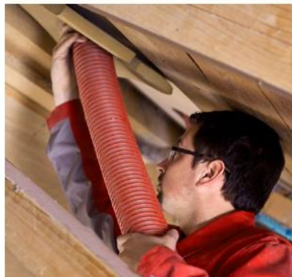
celulosa isofloc insuflada en cubiertas de madera
